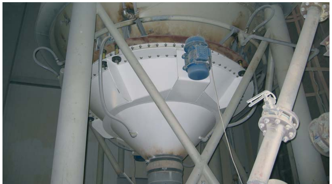
Eisen-II-Sulfat-Silo nach dem Umbau mit dem VIBOSTAR® VSN 1800
